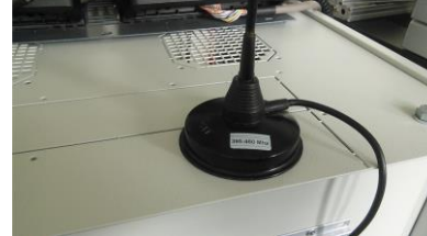
Équipement no 24 | Poste projet XX Description : fréquence PMR : 395/460 MHz Localisation :
