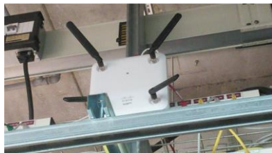
Équipement no 17 | Borne WIFI CISCO radio Description : CISCO AIRONET 1850 Localisation : Nombre d'équipement : 4
