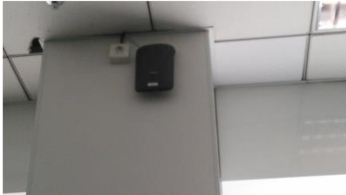
Équipement no 11 Borne DECT ASTRA : Localisation : Bâtiment A - RDC - devant le bureau HSE Nombre d'équipement : 72
