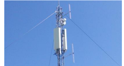
Équipement no 57 | FH 13 GHz Description : fréquence : 13 GHz Localisation : sur le toit
