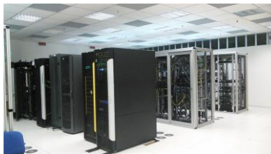
Équipement no 45 | Salle serveur Description : grande + petite Localisation : Nombre d'équipement : 2
